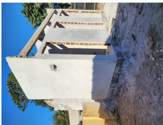
Situação registrada em maio de 2023. Estrutura dos banheiros já construída com viga e encanamento aparente
