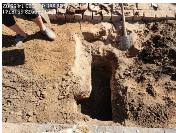
Ampliação do poço-teste em direção à viga de sustentação do pergolado (seta branca), e tentativa de ampliação em paralelo à viga (seta vermelha)
